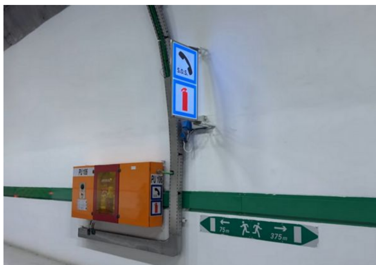
Postazione SOS per tunnel Frejus
